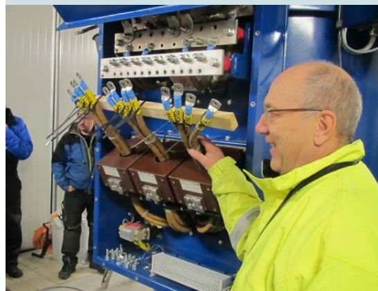
Ryddøla kraftverk er Blåfalls femte kraftverk på landsbasis. Bildet viser rådgiver Kolbjørn Dønåsen ved kraftverkets generator.
